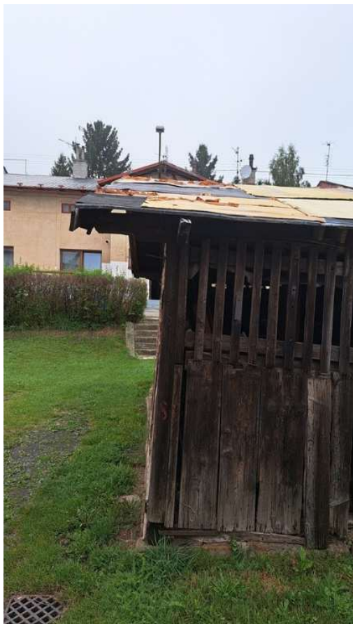
Obr. 5 – Podélná deformace rohového sloupku objektu.
