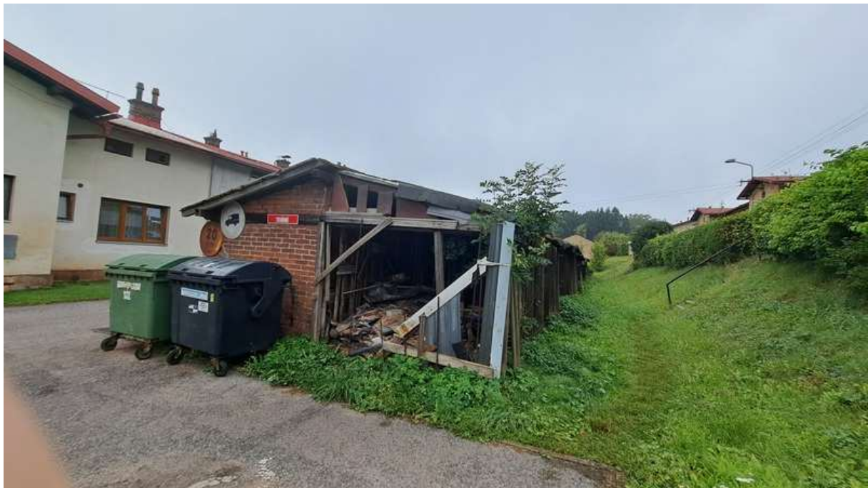
Obr. 6 - Částečně zřícená štítová stěna včetně chybějící vzpěry.
