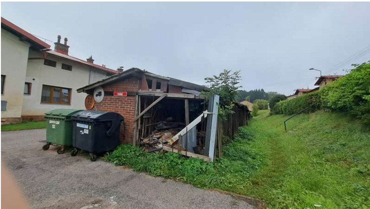
Obr. 6 - Částečně zřícená štítová stěna včetně chybějící vzpěry.
