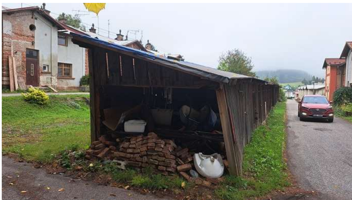
Obr.1 a 2 – Dodatečná dřevěná přístavba na konci ulice Tovární. Přístavba vykazuje značné deformace a doporučuji její včasné odstranění. Část objektu za přístavbou se nachází ve vyhovujícím stavu.
