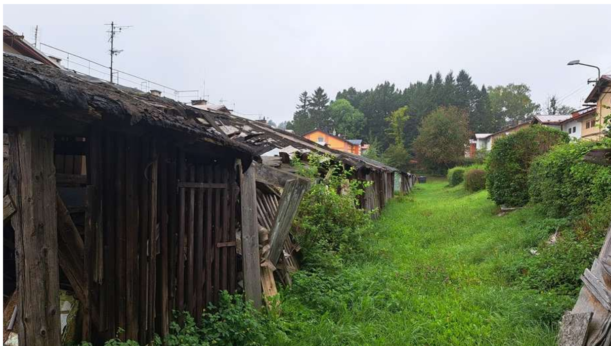
Obr. 8 – Naprostá destrukce nosné konstrukce střední části objektu.
