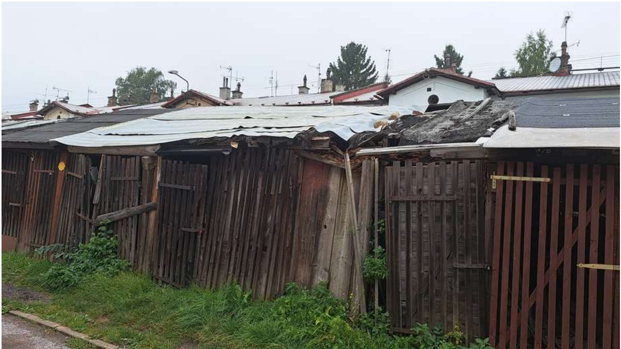
Obr.4 – Značná příčná deformace ve střední části objektu, konstrukční dřevěné prvky jsou zde napadené dřevokaznými houbami.
