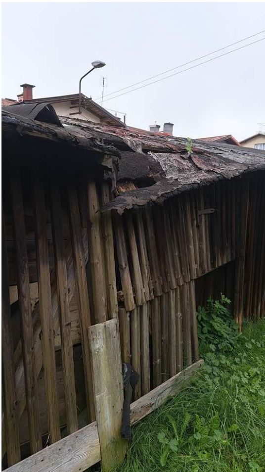
Obr. 7 a 8 – Totální degradace dřevěných nosných prvků způsobená dlouhodobým zatékáním do střešní konstrukce.
