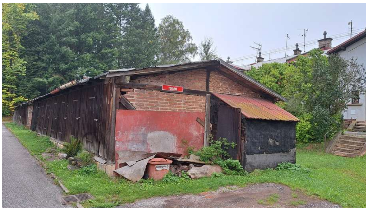
Obr. 7 - Vykloněné štítové zdivo provizorně zajištěné deskou, zcela ulomený čep šikmé vzpěry. Doporučuji vybourání zdiva a provést opravu spoje vzpěry sloupu.
