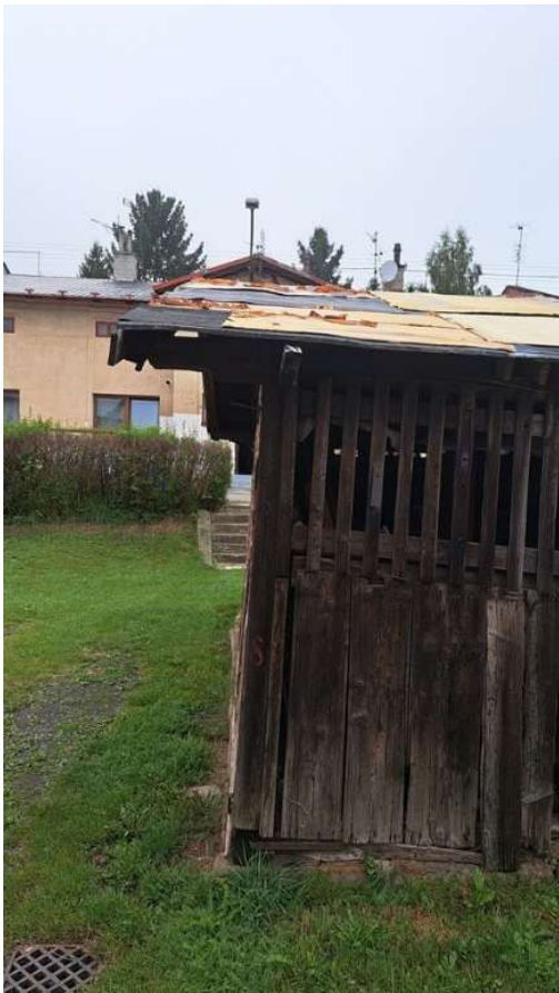
Obr. 5 – Podélná deformace rohového sloupku objektu.
